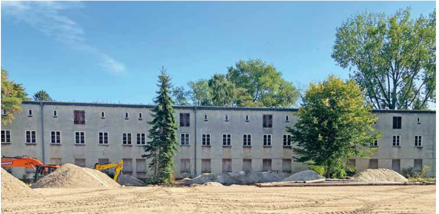
Die Bagger kommen: Das Haus V des Krankenhauses Priwall kurz vor dem Abriss im September 2021.
